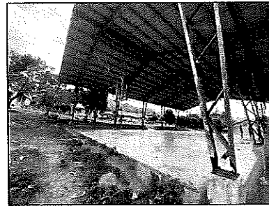
ACTUAL SITE CONDITION (PLAYCOURT SLAB)
